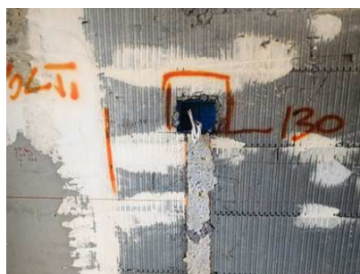
Scatole di derivazione impianto
